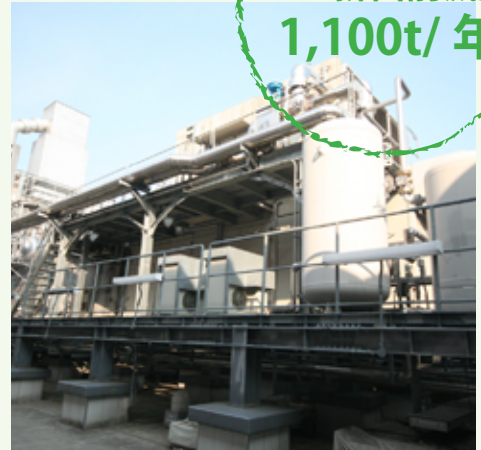
ガスタービンコジェネレーション設備 Gas turbine cogeneration facility
