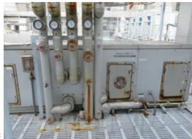
更新前の空調機器
