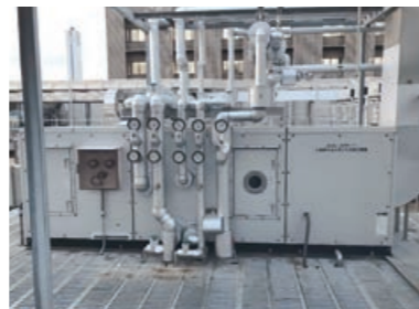
更新された空調機器
