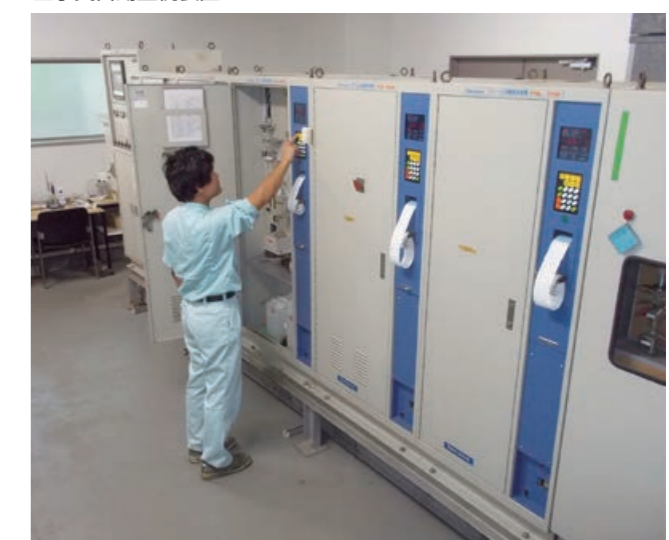
■水質自動監視装置
